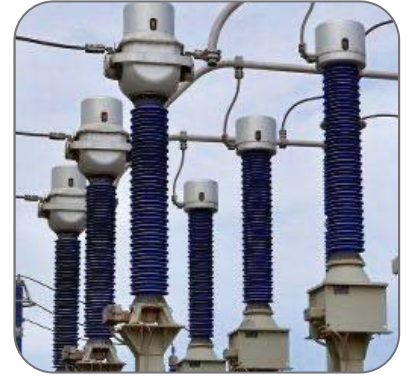
Transformadores de tensión y corriente en media tensión
