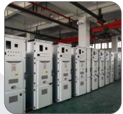
Celdas de distribución primaria y secundaria de BT y MT
