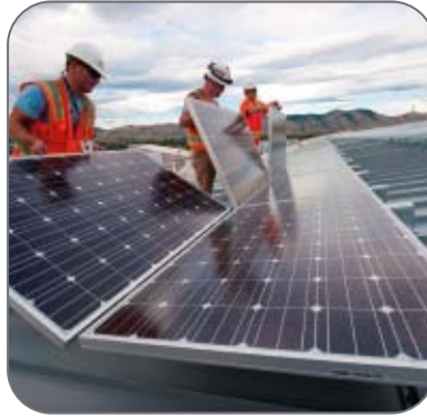
Generación solar y cargadores eléctricos
