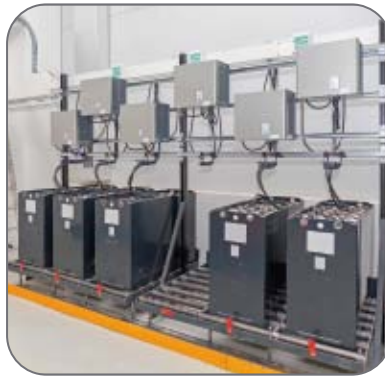
Banco de baterías y cargador-rectificador
